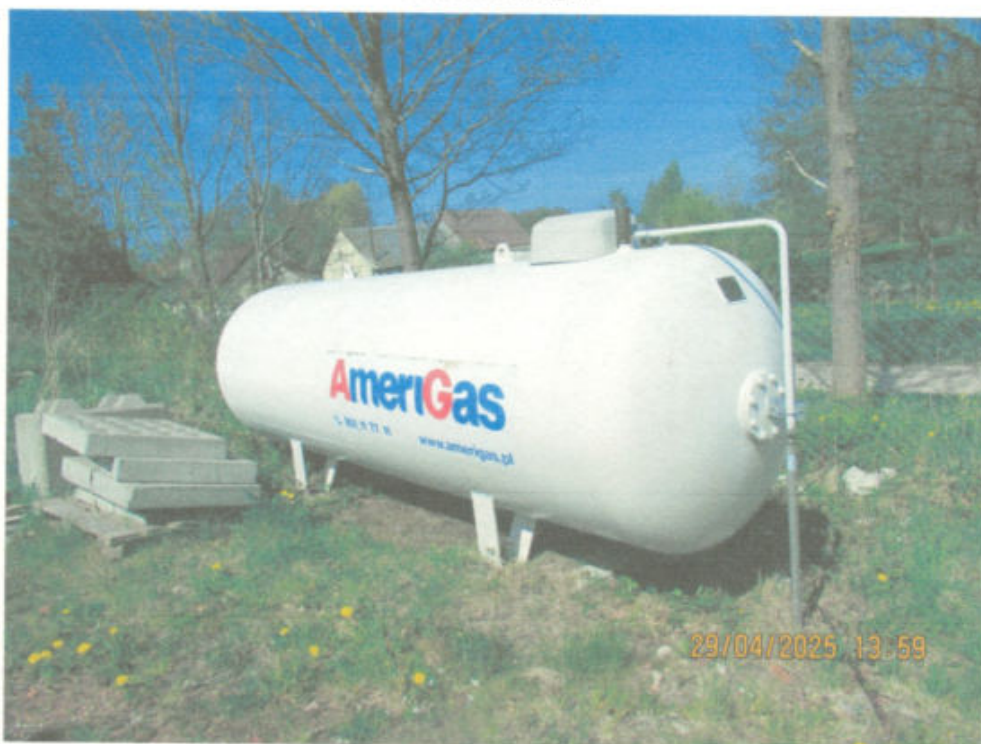
Zbiornik na gaz
