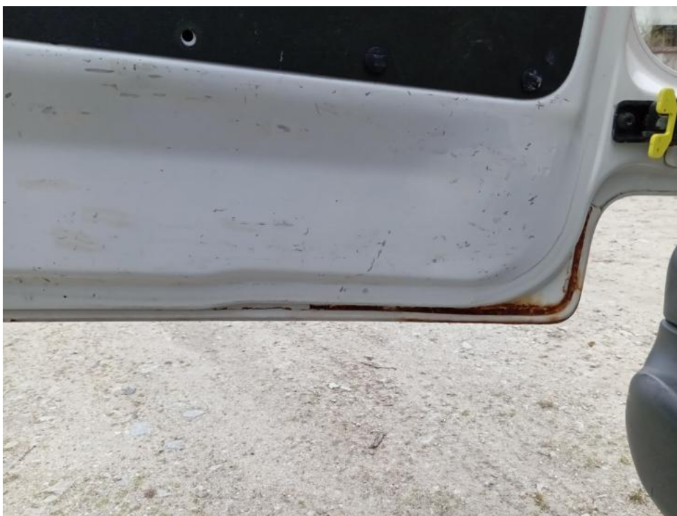
Fot. 47. TL() - korozja 3
