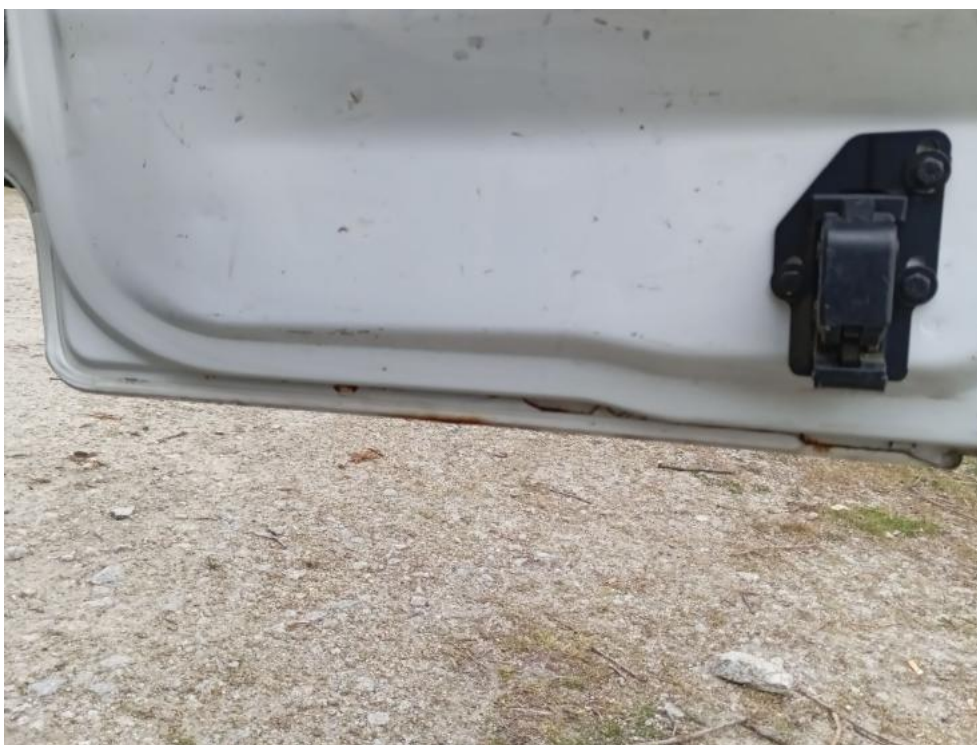
Fot. 39. TP() - korozja 3
